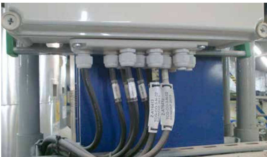
Instalacja odsiarczania spalin – Grupa Azoty PUŁAWY – zastosowanie przewodów BIT 1000® produkcji ZK BITNER
