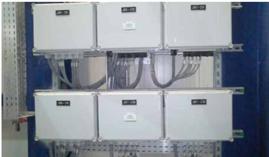
Instalacja odsiarczania spalin – Grupa Azoty PUŁAWY – zastosowanie przewodów BIT 500® i BIT500® CY produkcji ZK BITNER
